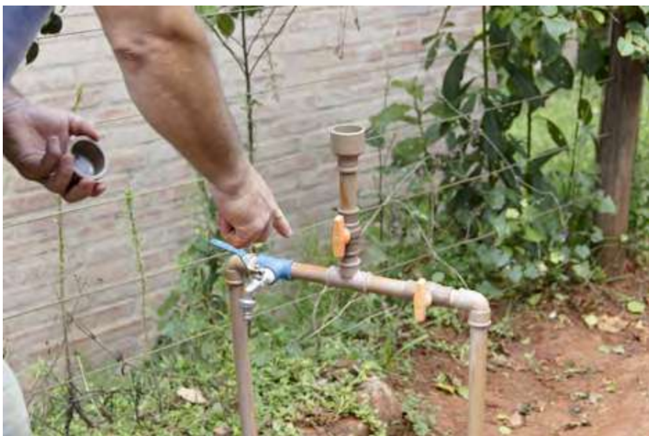
Figura 9 – Clorador Embrapa instalado em uma propriedade rural
