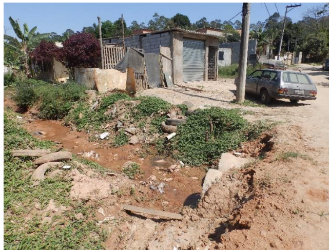
Figura 11 – Lançamento de esgotos em córregos verificados em Jardim Canaã.
