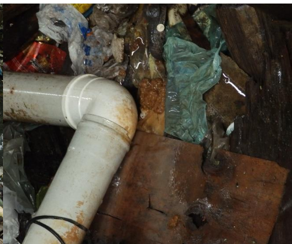
Figura 27 – Situações das ligações prediais de esgoto.
