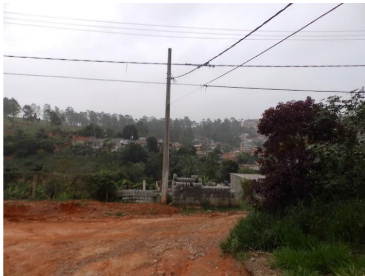
Figura 6 – Exemplo de furto na rede na energia elétrica em Jardim Canaã.
