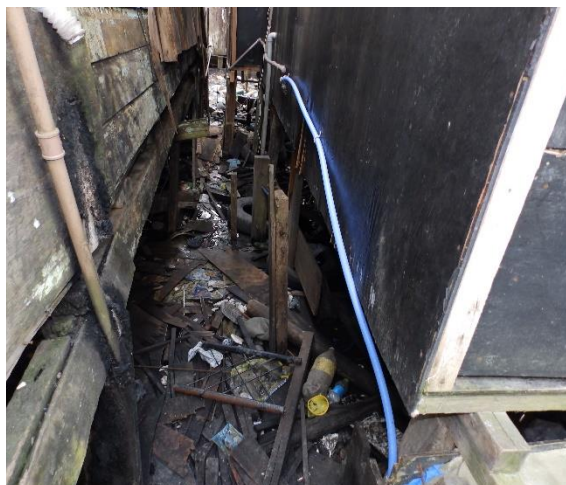
Figura 25 – Ligações de água através de mangueiras e tubulações.
