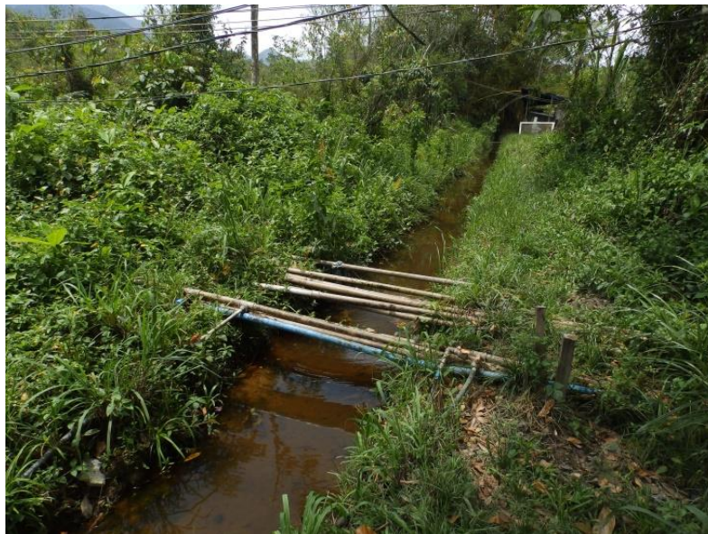
Figura 18 – Ligação para abastecimento de água da Cachoeira da Serra.
