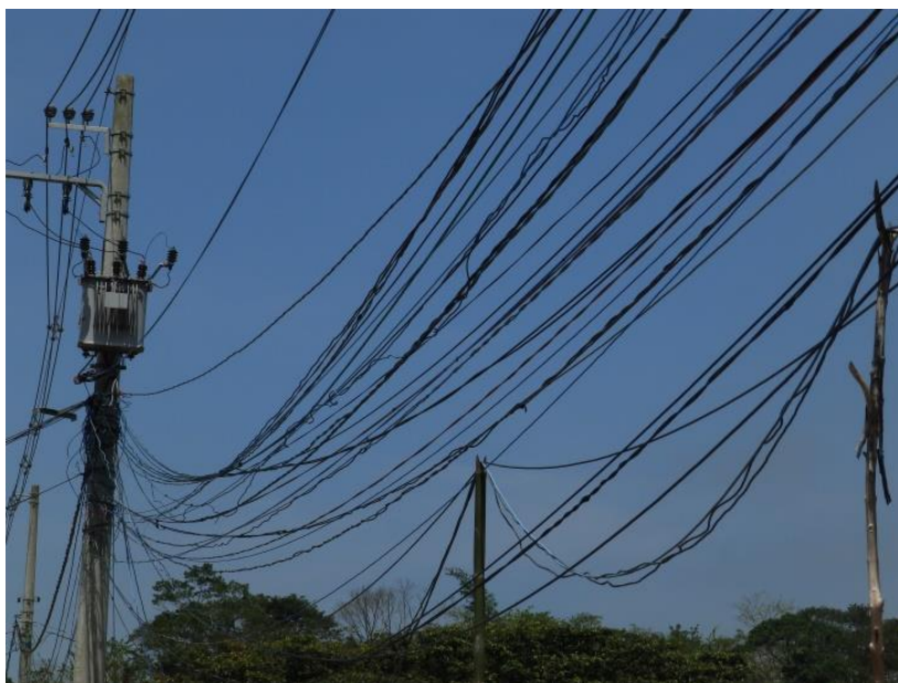
Figura 17 – Conexão clandestina a rede de energia elétrica em Baleia Verde.
