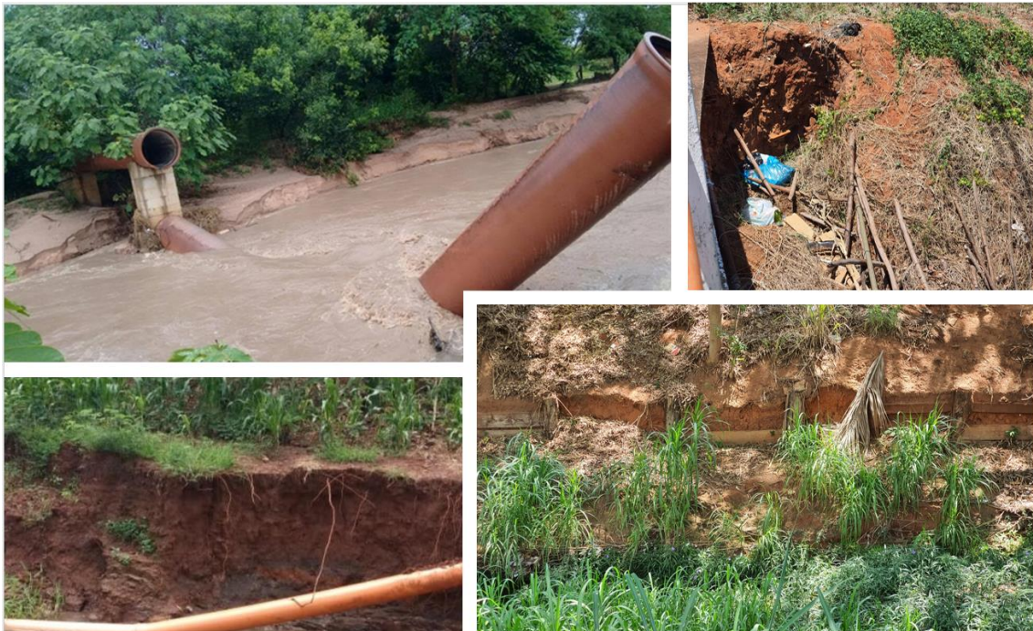
QUADRO 10: INTERCORRÊNCIAS DA FALTA DE MACRODRENAGEM
